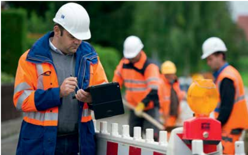
Mit Tablet an der Baustelle: Mitarbeiter der Qualitätssicherung arbeiten vor Ort mit einer App, über die Ergebnisse der Kontrolle in eine zentrale Datenbank übermittelt werden.
